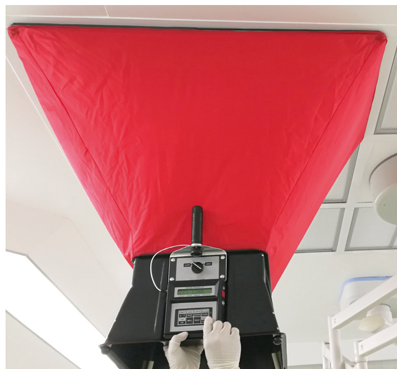
Mesure de débit au moyen d'un balomètre.
