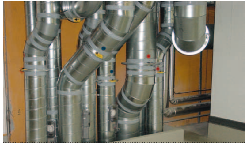
Le milieu comprend notamment le traitement et les réseaux de distribution d'air, d'eau et gaz courants.
